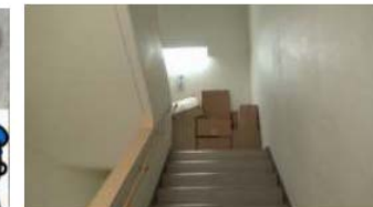
③ 階段室に段ボール箱等が存置
